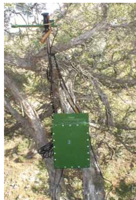
Рис. 3. Контролируемая станция на объекте Адыгене
