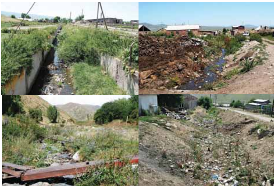
Рис. 2. Состояние русел ряда водотоков и бетонных водоотводящих сооружений в северных областях Армении (фото В. Бойнагряна)
