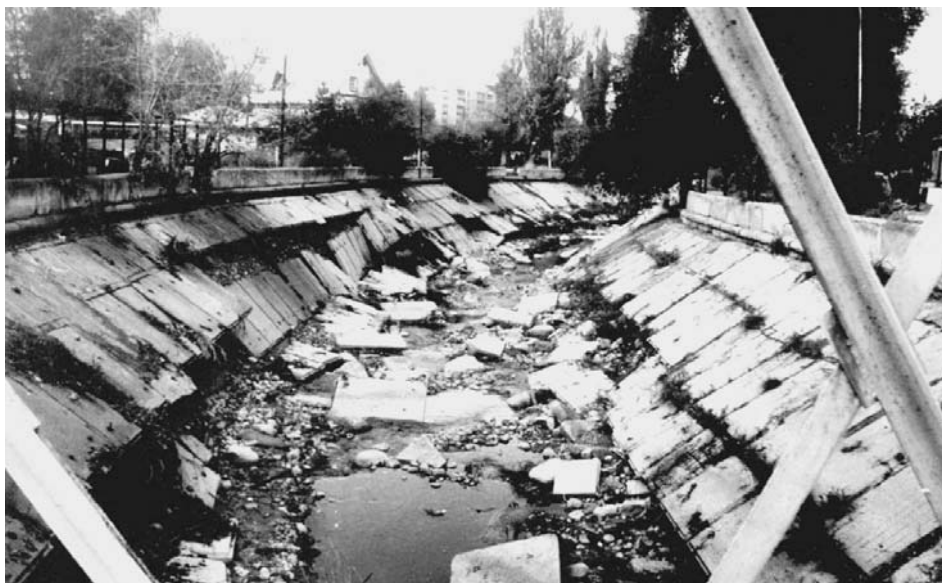
Рис. 71. Разрушение облицовки стабилизированного русла р. Весновка из-за эрозионного углубления дна (фото А.Х. Хайдарова).
