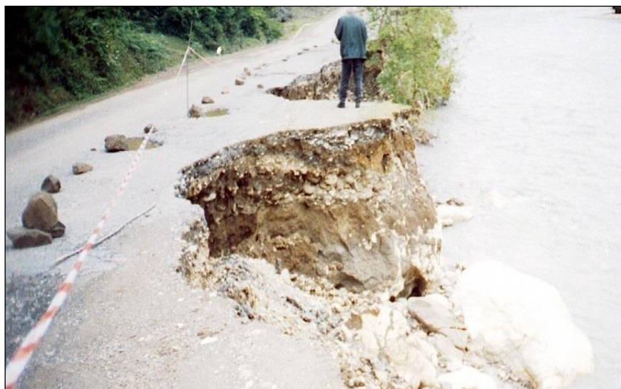
Рис. 3. Состояние автомобильной дороги на правом берегу р. Цхенисцхали.
