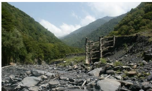
Разрушенная селезащитная плотина на реке Дуруджи выше города Кварели
