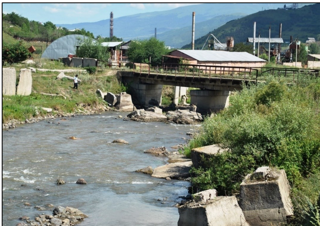
Рис. 14. Остатки строительных конструкций в русле верхний р. Дебед. Фото В. Бойнагряна
