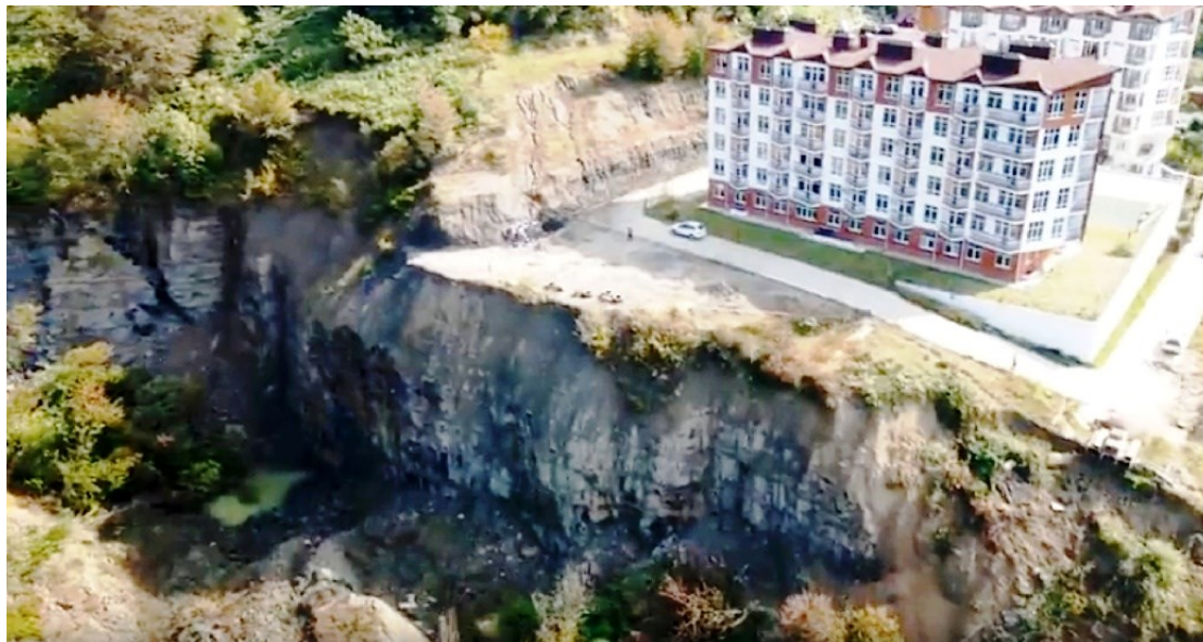
Рис. 4. Разрушение склона в районе новой застройки в Чвежипсинском подрайоне, бассейн реки Вост. Дагомыс (с. Сергей-Поле, 2021 г.)
