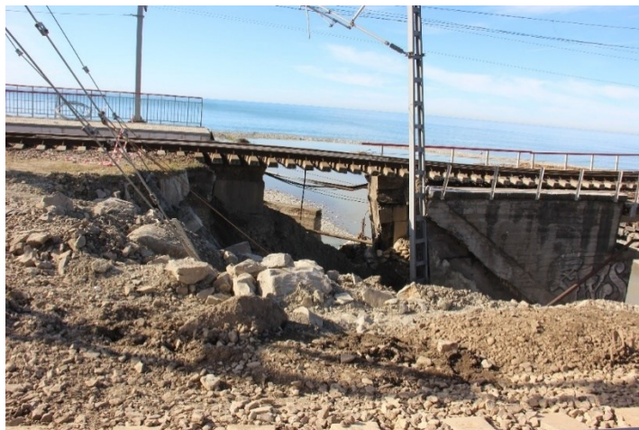
Рис. 2. Опоры железнодорожного моста у платформы Макопсе в Краснодарском крае, подмытые селевым паводком 24 октября 2018 г. Фото С.С. Черноморца
