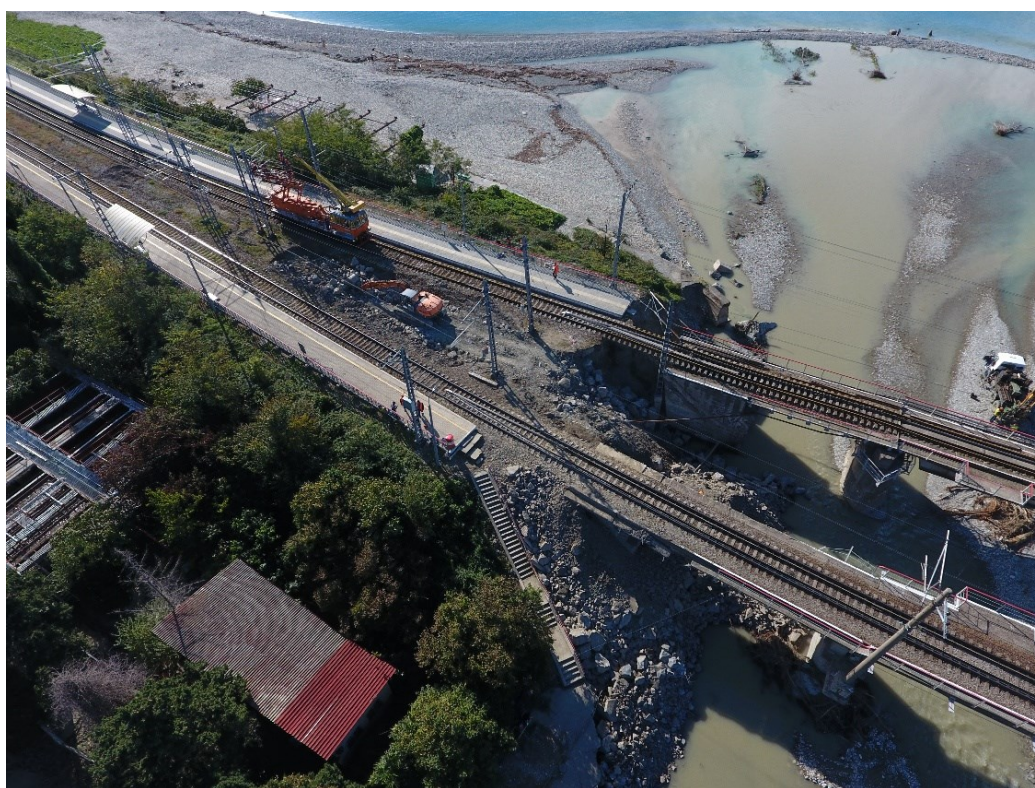
Рис. 1. Железнодорожные пути над опорами моста у платформы Макопсе в Краснодарском крае, подмытыми селевым паводком 24 октября 2018 г. Фото с квадрокоптера 30 октября 2018 г. Снимок С.С. Черноморца.
