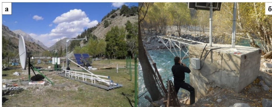
Рис. 5. Гидрометеорологическая станция Майдантал (MTAL) в Узбекистане: а) общий вид площадки метеостанции с установленной спутниковой системой VSAT; б) автоматизированный гидропост, включающий датчик скорости воды и датчик уровня воды в реке типа Sommer RQ-24
