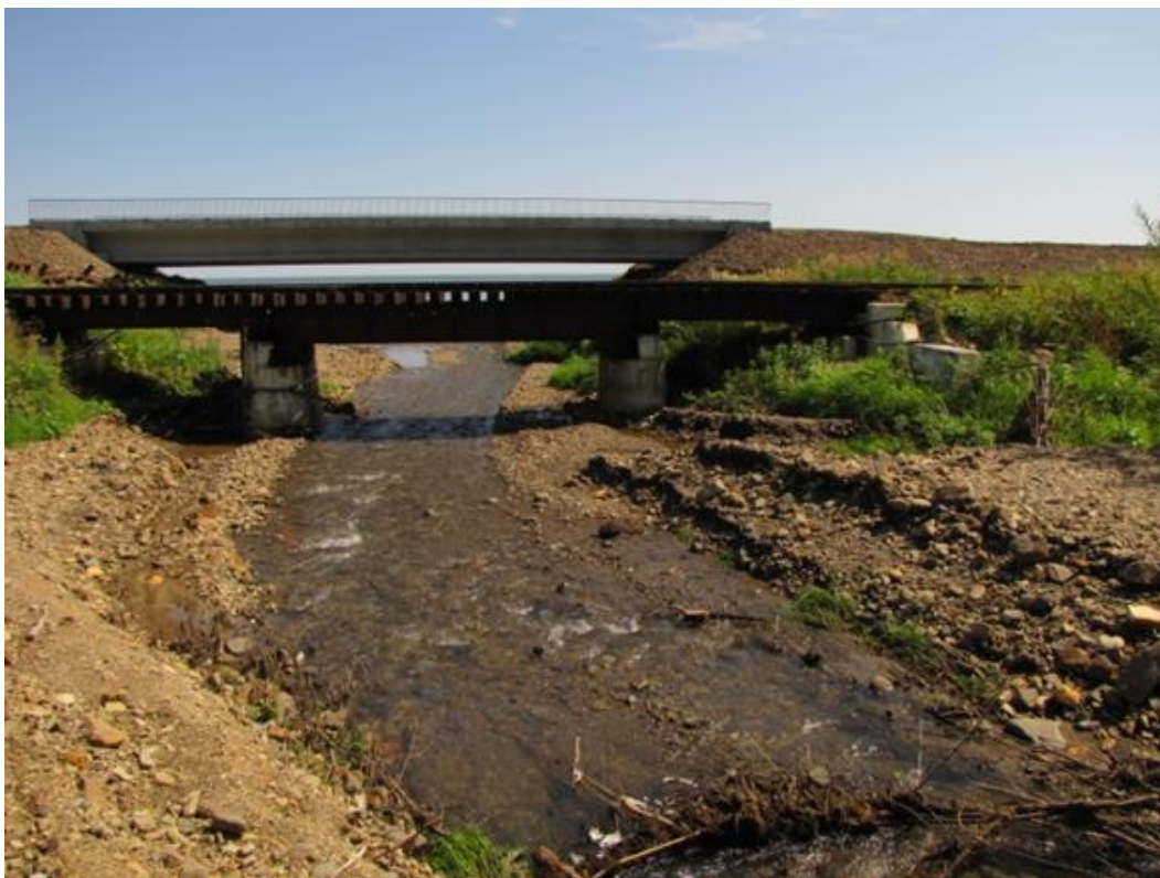
Рис. 2. Мостовой переход железной дороги (на переднем плане) и селепропускное сооружение под автомобильной дорогой (на заднем плане) на р. Жаровка (Макаровский район)
